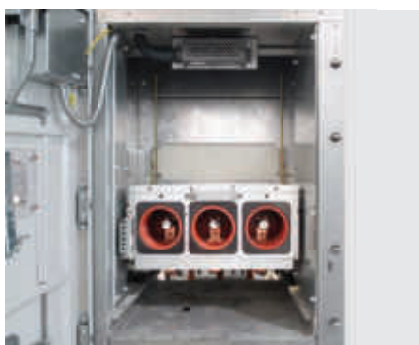
Выдвижные трансформаторы тока
