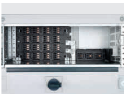
Втычные разъемы в отсеке выкатного модуля
